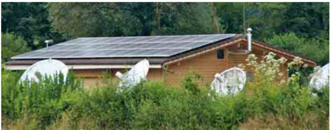
Kopfstation Kabel-TV-Netz: PV-Anlage mit Eigenverbrauch
